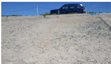
Рисунок 1. Плиты крепления верхового откоса плотины Новосибирской ГЭС.
