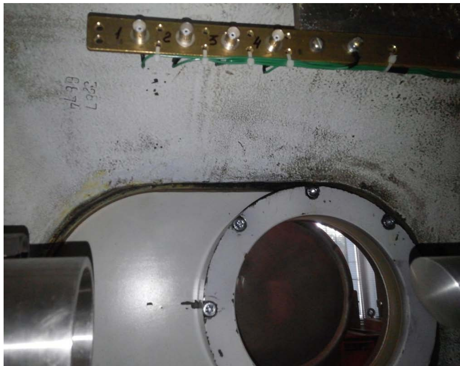
Рис. 121. Крепления разъемов BNC внутри секции ресивера.
